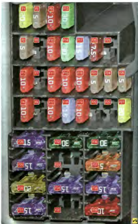
Рис. 10.1. Номера предохранителей в монтажном блоке, расположенном в салоне
